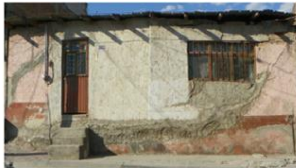
Figura 5.1 Evaluación de vulnerabilidad sísmica vivienda de mampostería no reforzada mal confinada, vivienda V2 en manzana M2.
