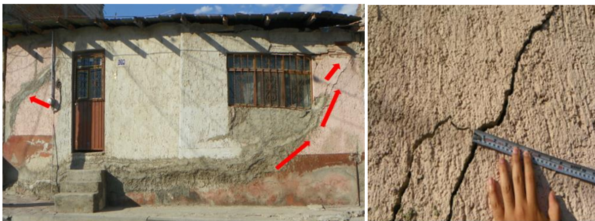
Figura 4.8. Vivienda V2 de la manzana M2; a) agrietamiento vertical y escalonado en muro b) medición de grieta.
