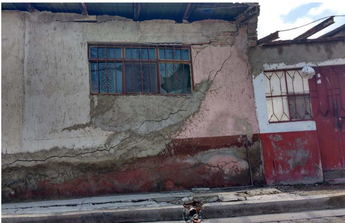
Figura. 1.6. Vivienda dañada ubicada en calle Juárez. Jocotepec (2016).
