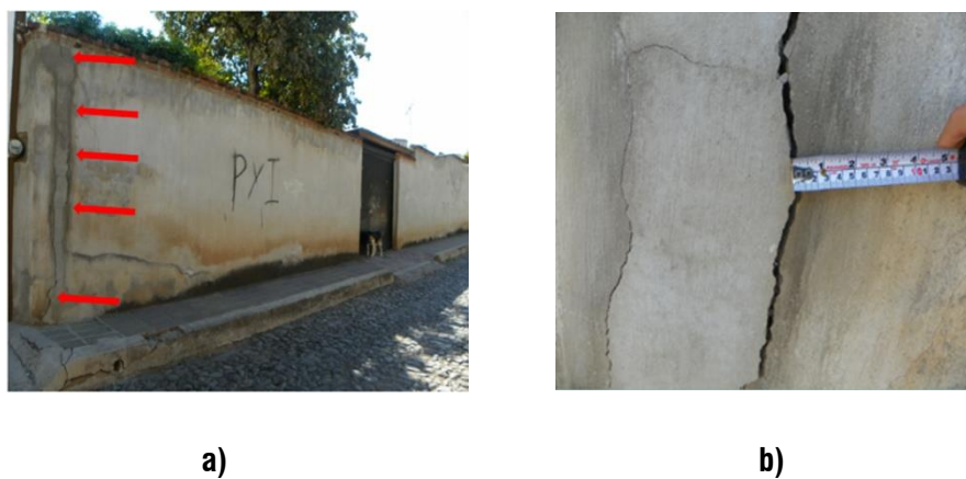
Figura 4.3. Vivienda V2 de la manzana M1; a) presencia de grieta vertical b) medición de grieta.
