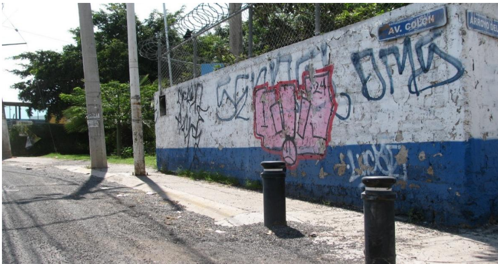
Figura 21. Señalética en malas condiciones, bolardos y postes mal colocados. Foto: Abel Gómez (2025)
