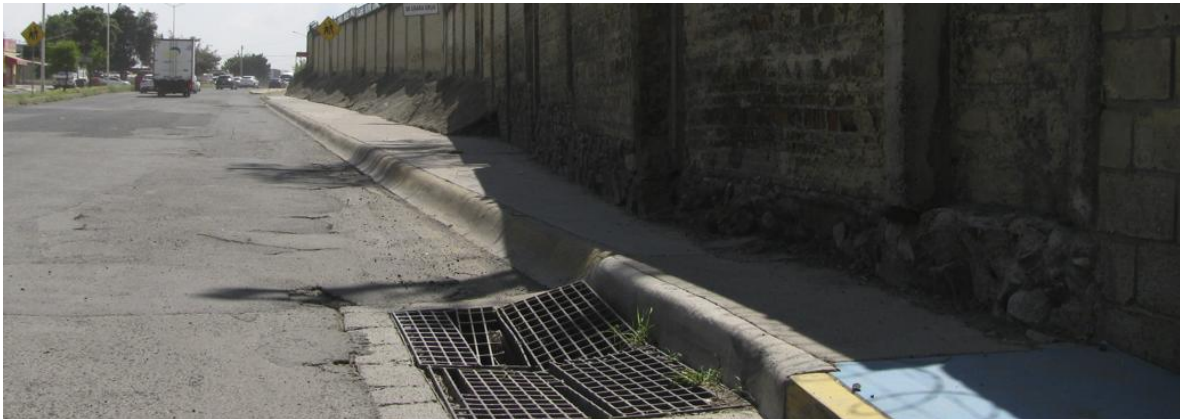
Figura 22. Boca de tormenta en mal estado. Foto: Abel Gómez (2025)
