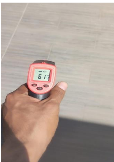
Figura 35. Temperatura superficial que supera los 60°C. Foto: Abel Gómez (2025)
