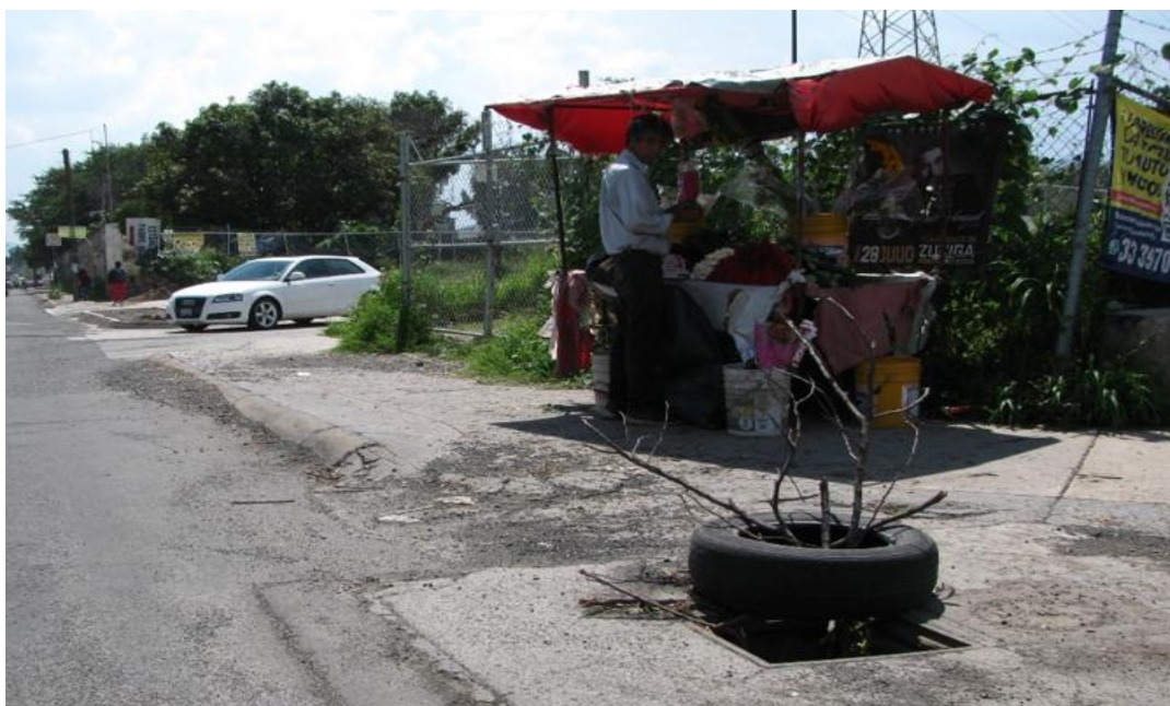
Figura 42. Banqueta de av. Prolongación Colón con mal aspecto. Foto: Abel Gómez (2025)
