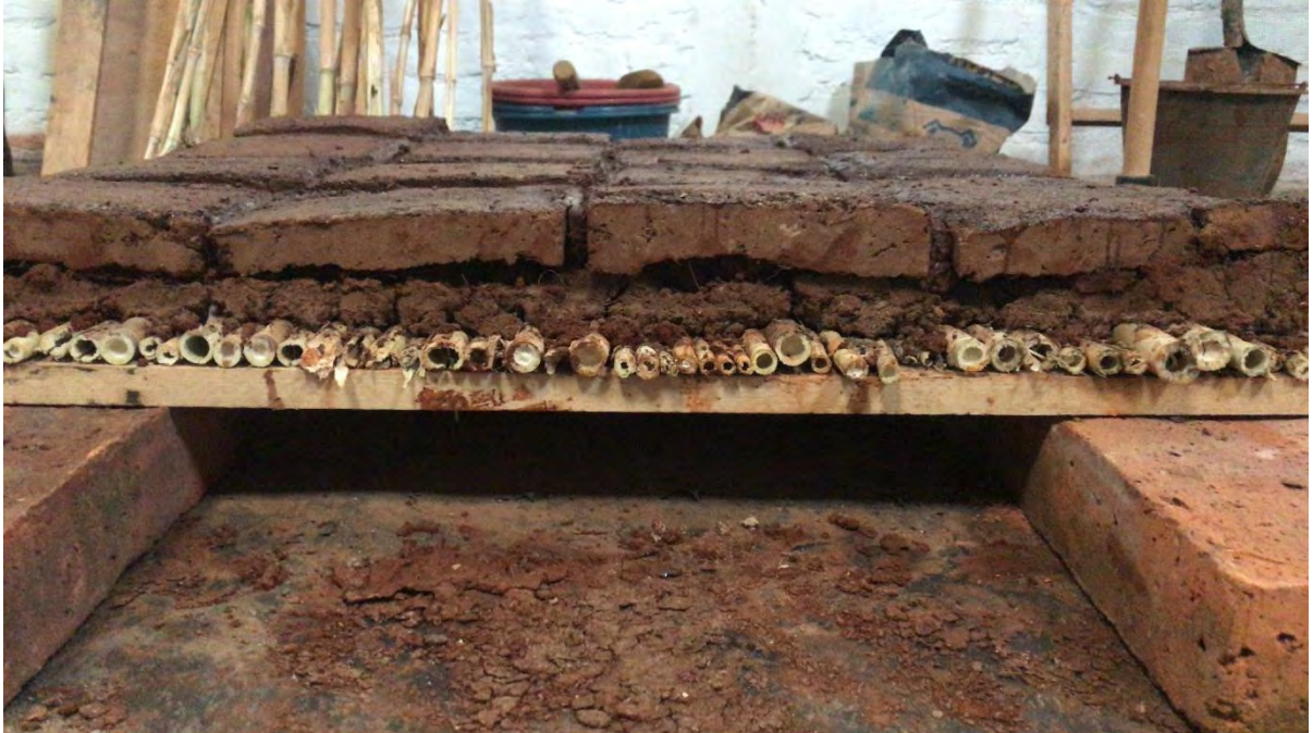
Figura 4.13. Cubierta de carrizo con zotehuela de tierra curda. Fuente: Propia, en trabajo de campo 2021.
