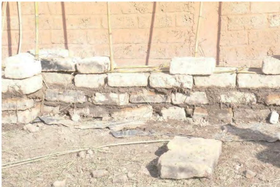
Figura 2.11. Muro de adobe reforzado en el museo regional de Mezquitic, en la Sierra Norte de Jalisco. Fuente: Elaboración propia, 2019.
