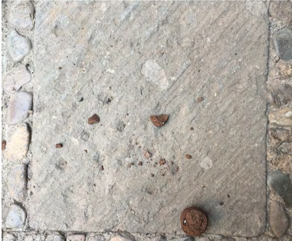
Figura 4.10. Prueba de retracción. Fuente: Propia, en trabajo de campo 2020.
