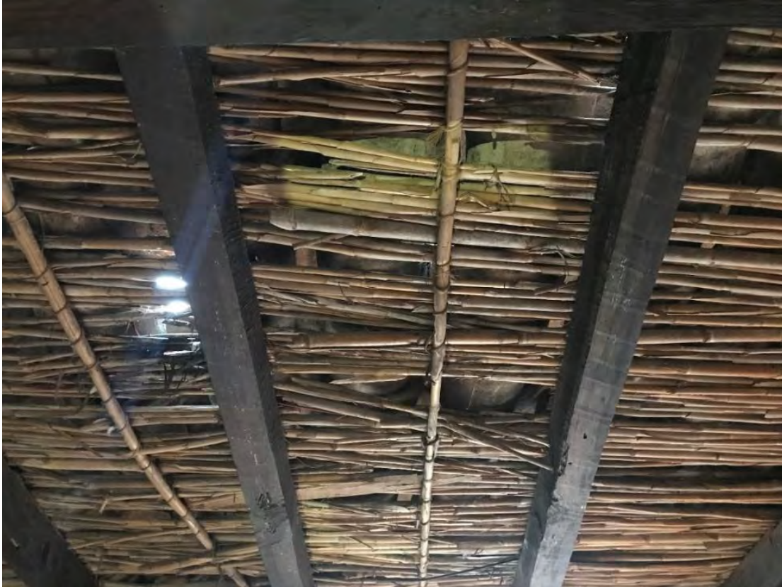
Figura 2.18. Cubierta de carrizo con traves de madera de mezquite en una vivienda en la colonia Centro, sobre la calle Colón, en el municipio de Arandas. Fuente: Elaboración propia, 2019.
