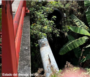
Estado del drenaje del río
