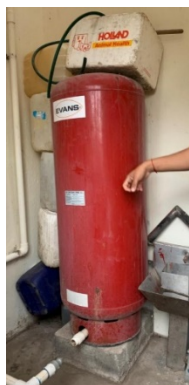
Imagen 4. Tanque de agua sin funcionamiento en el rastro
