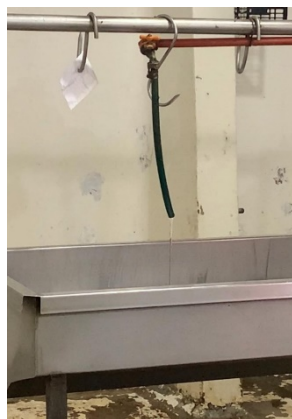
Imagen 5. Llave que permanece abierta para no quemar la bomba.
