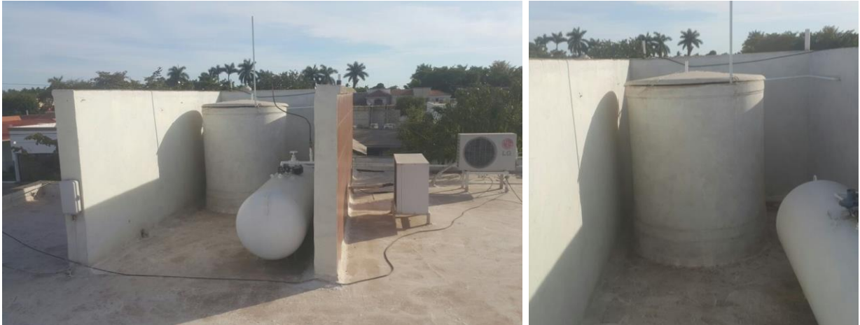
Imagen 33. Tinaco de la vivienda.
