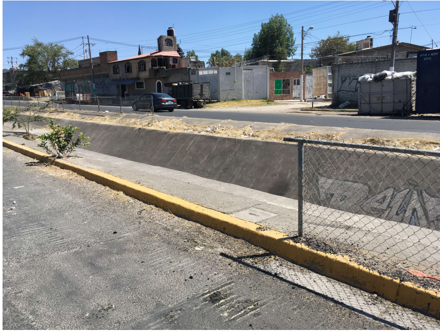
Ilustración 47. Malla incompleta junto al canal.
