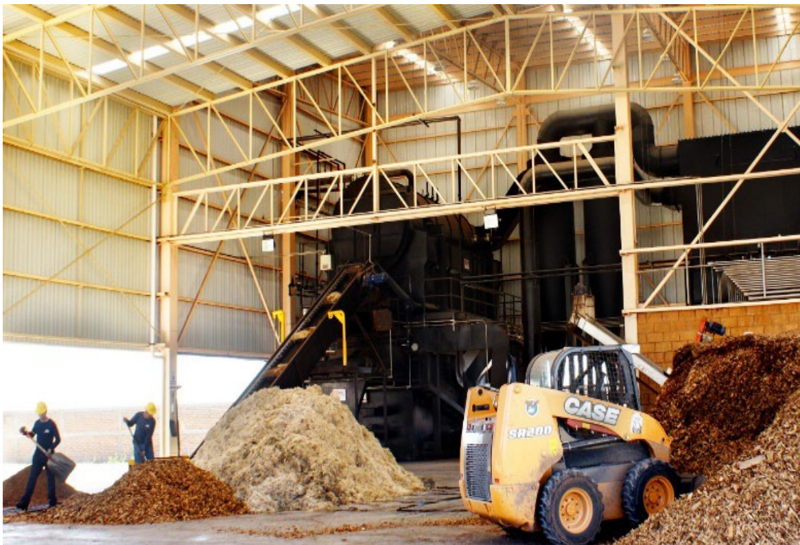
Figura 8, Vapor de caldera ecológica que utiliza biomasa de bagazo de agave y otras materias primas orgánicas como combustible ( https://www.gob.mx/firco/articulos/caldera-ecologica ).
