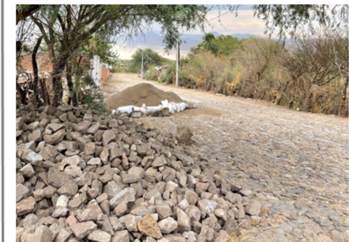
Escombro sobre banquetas y calles.
