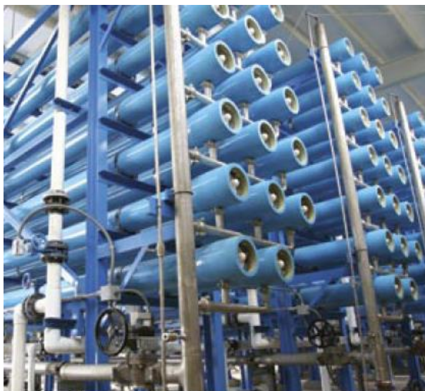
Figura 1.1. Planta desalinizadora por ósmosis inversa, de Cabo San Lucas [Conagua, 2008].
