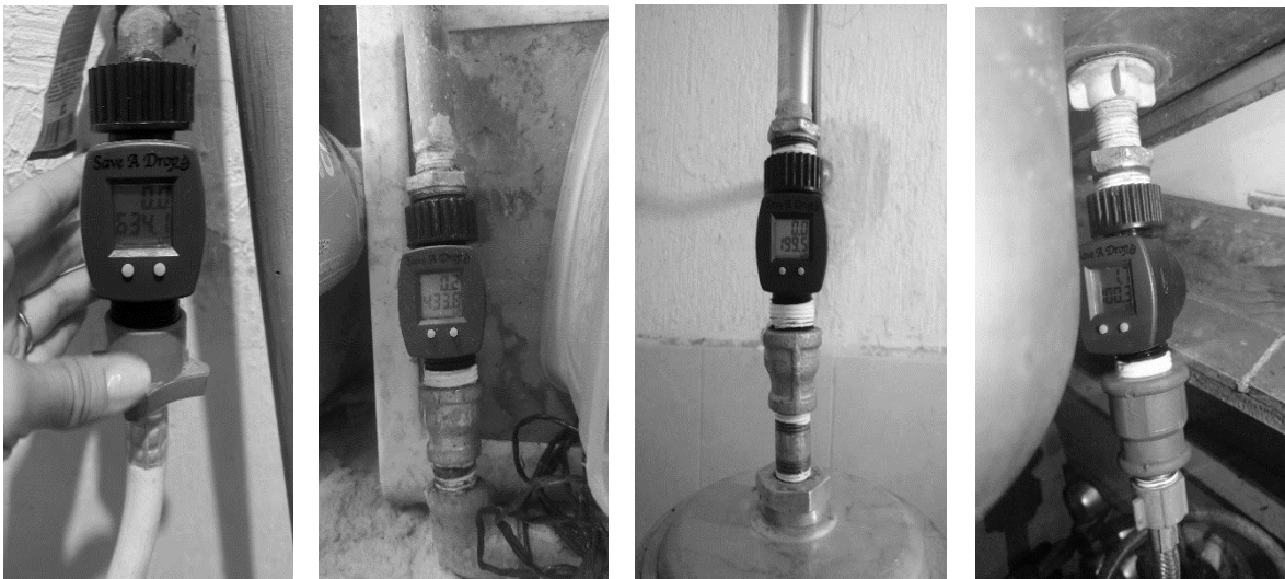
Figura 5.1 Medidores de caudal instalados en los casos de estudio
