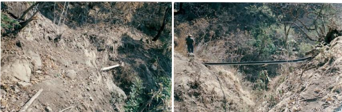
Figuras 31 y 32. Trabajos de construcción del proyecto 'Línea de conducción Copala-San Isidro-Alista'.
